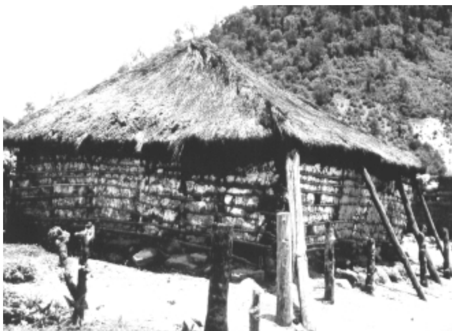
5-2 Vivienda de bahareque afectada por un sismo en Guatemala (Minke 2001)
